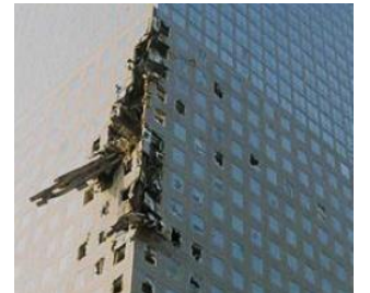
Figure 6: Elément de structure de la Tour Nord planté dans le World Financial Center 3
